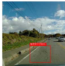
路面ひび割れ
